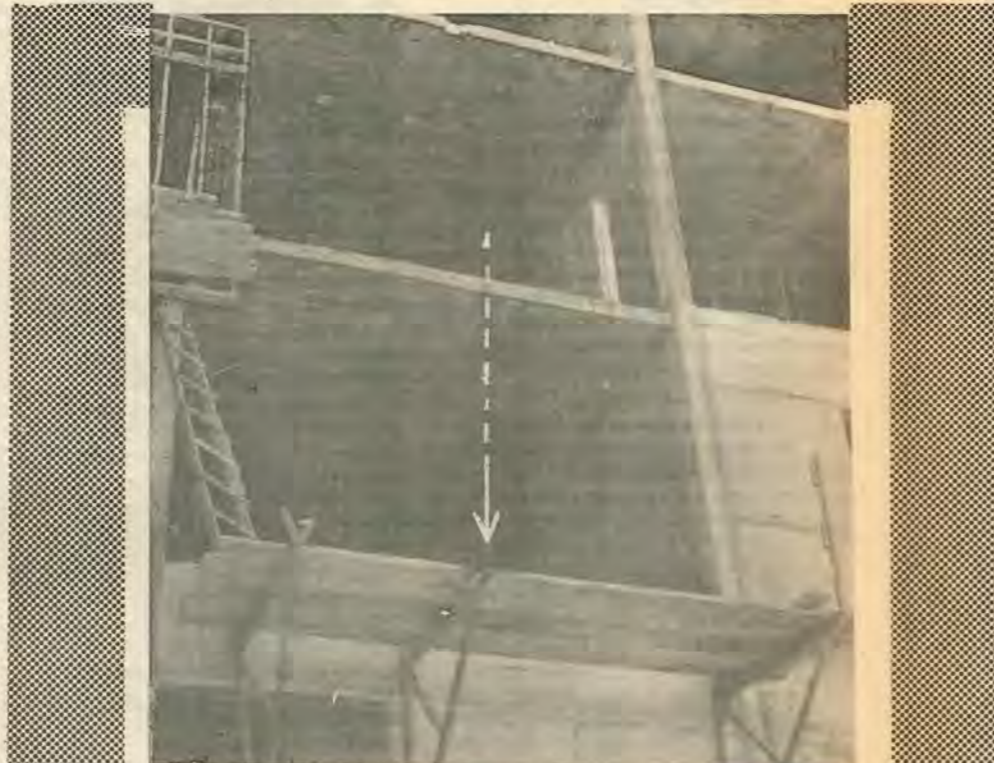
Το δυστύχημα στη ΣΑΥΠΑΡΚΟ. Ο εργάτης Σάββας Χρήστου απαγκιστρώθηκε καλούπια από το γερανό στο τρίτο όροφο κι' έπεσε κάτω. Ούτε σκαλωσιές ούτε προστατευτικά δίχτυα ή σχοινία. Πέφτοντας χτύπησε στο σίδερο μικρής σκαλωσίας στο δεύτερο όροφο που δεν είχε ξύλα για κουπαστή. Αυτό τον σκότωσε.
